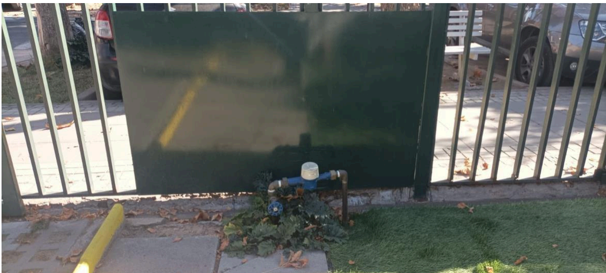
Imagen de medidor de agua potable (llave de corte)
