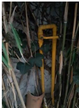
Imagen de llave de corte ubicada detrás sala de profesores.
